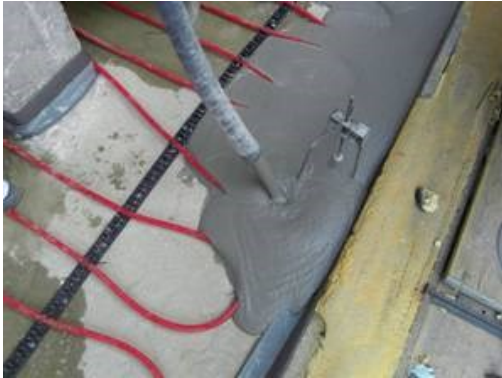
Figure 4: Concrete Core Activation. Apolonio Morales 29, Madrid. Source: IEI Instituto Europeo de Innovación.
