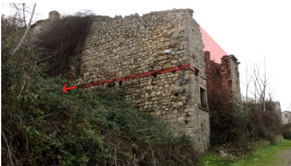
Figura 77. In alto : Cinematismo di danno in assenza di catene. Il muro di spina è coinvolto in un meccanismo di ribaltamento composto con tipico strappo diagonale rispetto al fronte. (G. Ajò, foto gennaio 2018)
