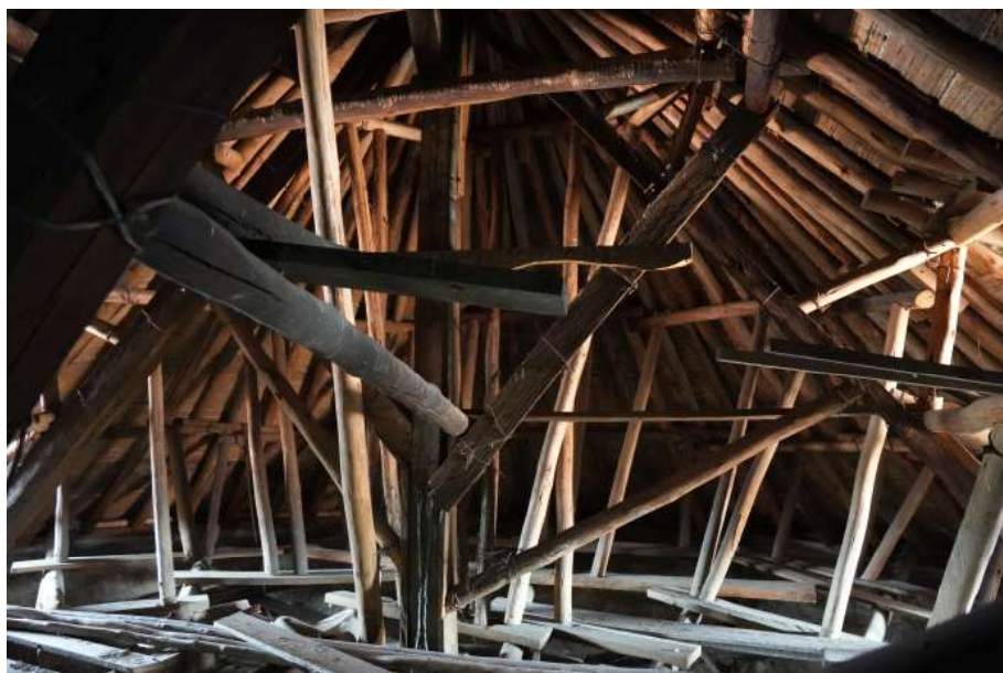
Fig. 4. Estado actual del extradós de las bóvedas de la catedral de Zipaquirá (Autor, 2025).
