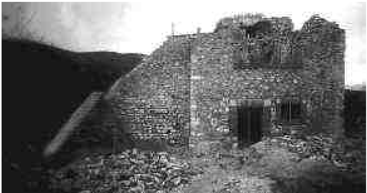
Fig. 14. Butrinto. Castello veneziano, resti della torre principale, prospetto sud. Stato precedente all'avvio delle operazioni di restauro (cortesia James G. Schryver).
