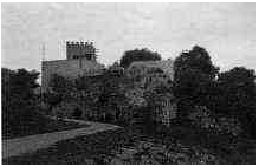
Fig. 48. Butrinto, castello veneziano. Il versante occidentale durante i lavori di ricostruzione (cortesia famiglia Taddei).
